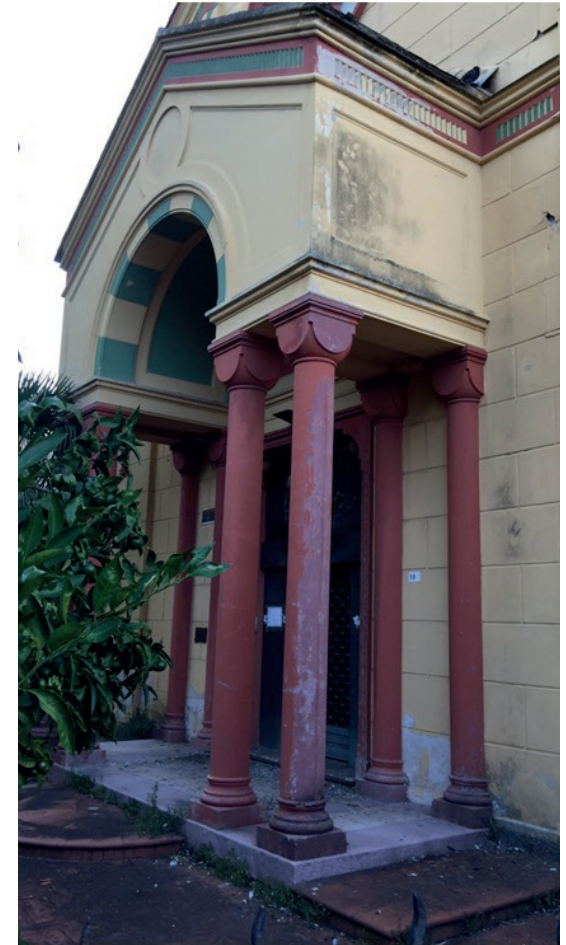
Fig.2 Segni di degrado della Saint George's Church di Rapallo (r.c.)
