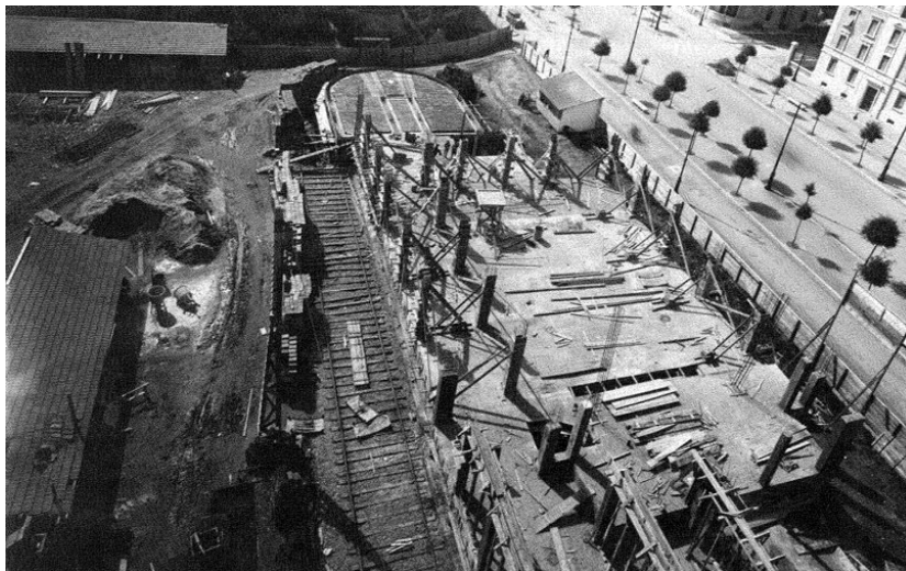
Fig. 8 - vista dalla torre del binario per la gru e zona culturale, primo solaio.
