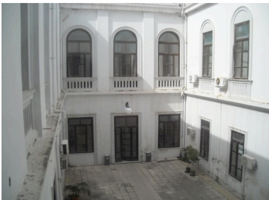
Fig. 5 - Aggressione impiantistica: cortile interno, chiostрина, prospetto posteriore, terrazza di copertura.
