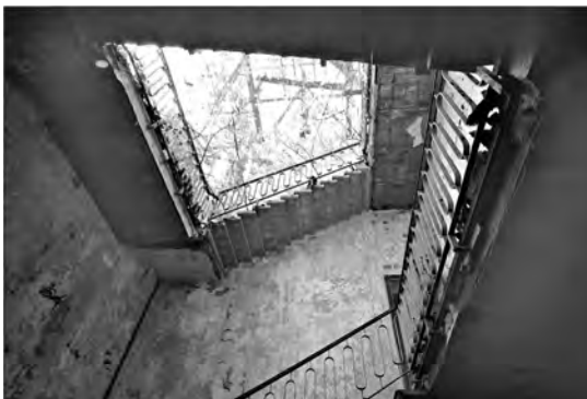
Fig. 22. Palazzina "Primo Levi": foto dell'ampio vano scale della storica sede direzionale. Fonte: R.S.A. s.r.l.
